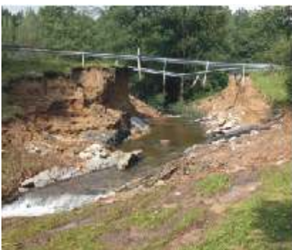
Bild 1: Gebrochener Straßendamm im oberen Einzugsgebiet
