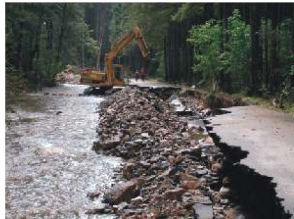
Bild 5: Durch das Hochwasser zerstörte Straße
