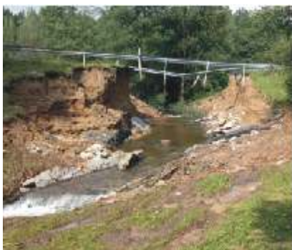
Bild 1: Gebrochener Straßendamm im oberen Einzugsgebiet
