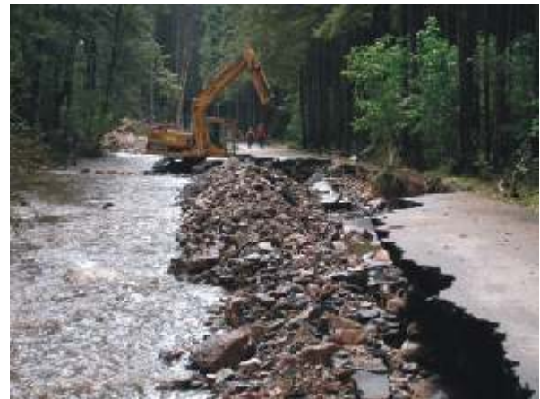
Bild 5: Durch das Hochwasser zerstörte Straße
