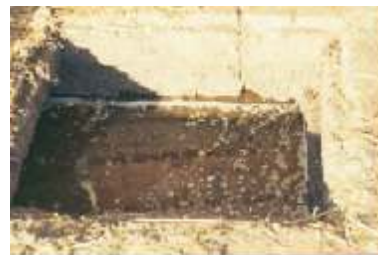
Foto 8: Risse und Abplatzungen (offenkundige Undichtheiten)
