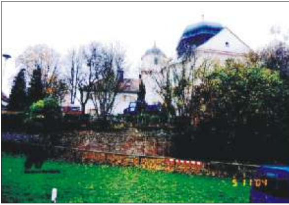
Abb. 2: Verstürzte Stützmauer unterhalb der Wallfahrtskirche Frauenbrünnl.
