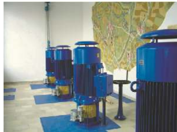
Bild 4: Blick in das Schöpfwerksgebäude mit den vier Motoren
