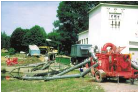
Bild 1: Mobile Hochwasserpumpen im Einsatz nach dem Ausfall des Schöpfwerkes.
