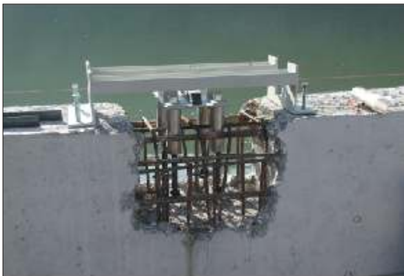
Abb. 3: Ankerplatte des mobilen Hochwasserschutzes
