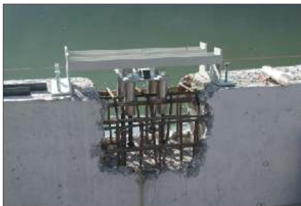
Abb. 3: Ankerplatte des mobilen Hochwasserschutzes
