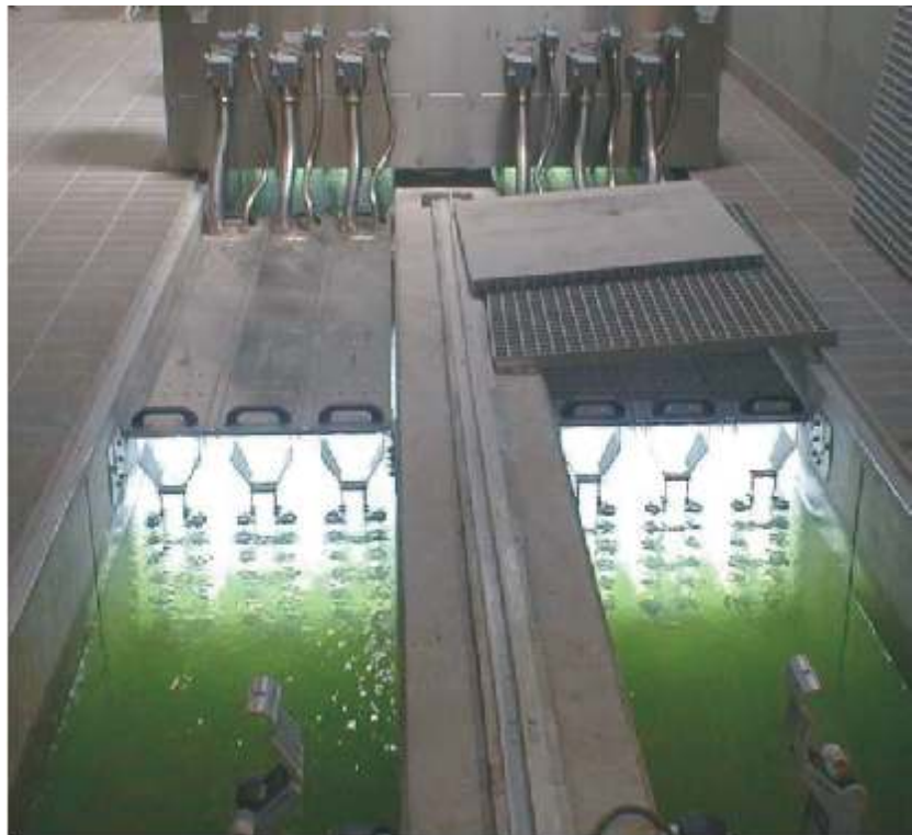
Bild 5: UV-Anlage in Betrieb
