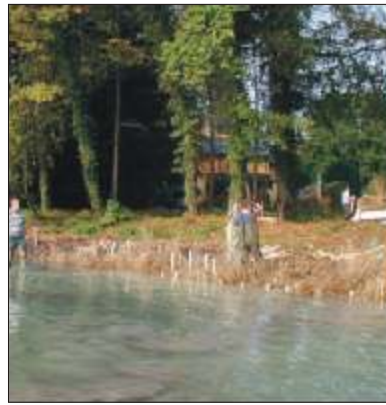
Abb. 6: Mitarbeiter des Wasserwirtschaftsamtes München verlegen gemeinsam mit Landesbund für Vogelschutz einen Schilfrollrasen am Ufer der Roseninsel (Bild: Wasserwirtschaftsamt München)
