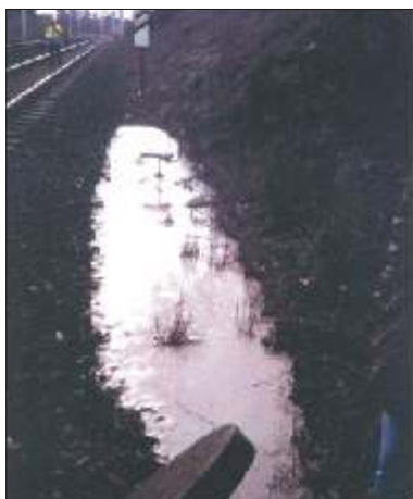
Bild 9: Bentonitaustritt HDD - Verfahren neben Bahndamm
