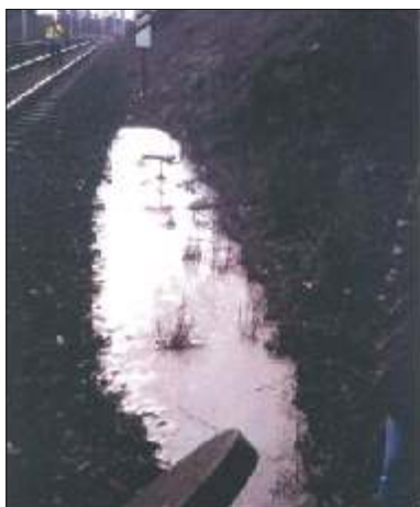
Bild 9: Bentonitaustritt HDD - Verfahren neben Bahndamm
