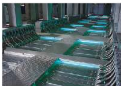
Installierte UV-Anlage „TAK“ zur Desinfektion von Abwasser in Manukau / Neuseeland
