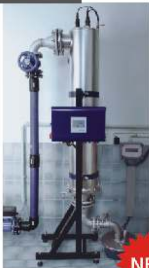
WEDECO „Spektron“ UV-Installation in Leopoldsdorfer / Deutschland
