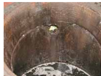
Abb. 1: Durchgefallen: Veraltete Ringbauweise mit undichten Fugen und Korrosionsschäden – ein typisches Schadensbild und ein klares Nein des Prüfers zum weiteren Betrieb. Bild: Mall
