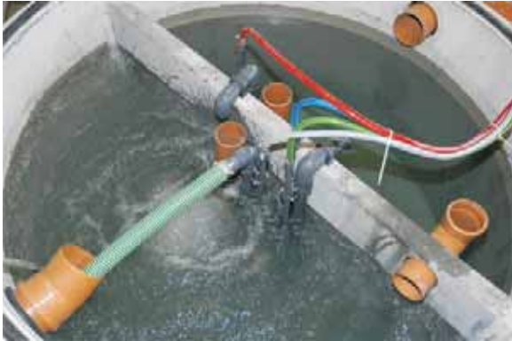
Abb. 3: Immer am Optimum. Auf Standortvorgaben bezogene Effizienz mittels chargenweiser Reinigung in der belüfteten Belebungsstufe. Bild: Mall
