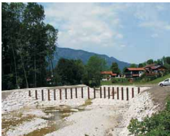
Abb. 3: Wildholzrechen im Wössener Bach
