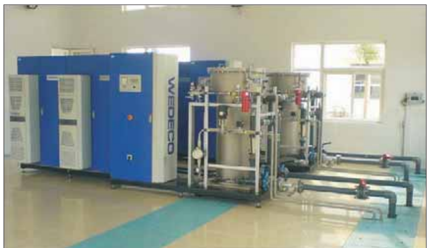
WEDECO Ozonanlage 2x SMO 600 (2 x 8kg/h aus Sauerstoff), installiert im Wasserversorgungsbereich der chinesischen Stadt Pinghu
